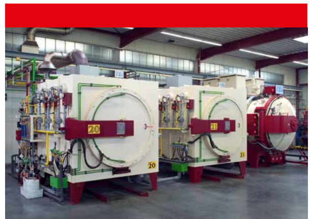
Gasbeheizte Nitrieranlagen bei Lohnwärmebehandler
