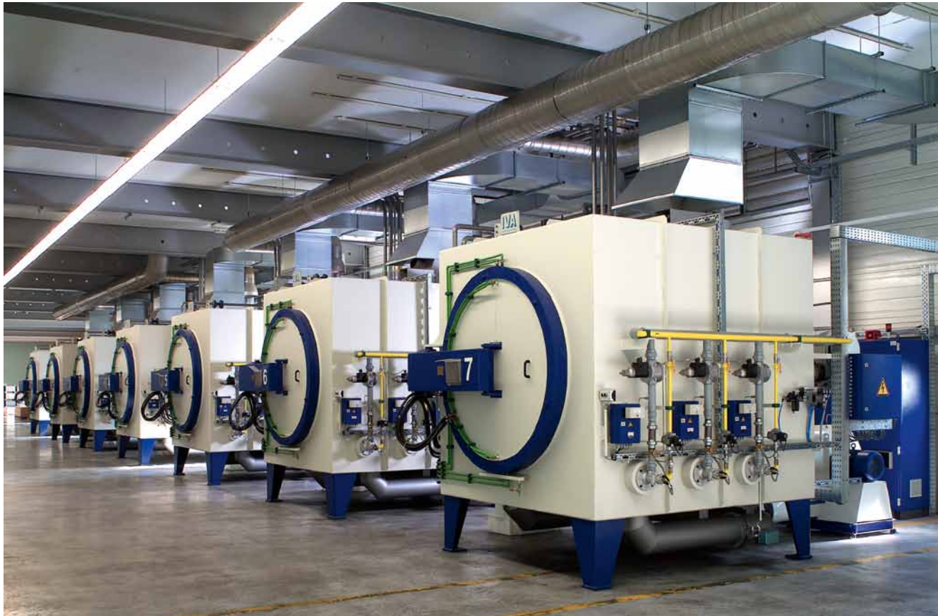
Linie mit gasbeheizten Nitrier-/Nitrocarburieröfen
